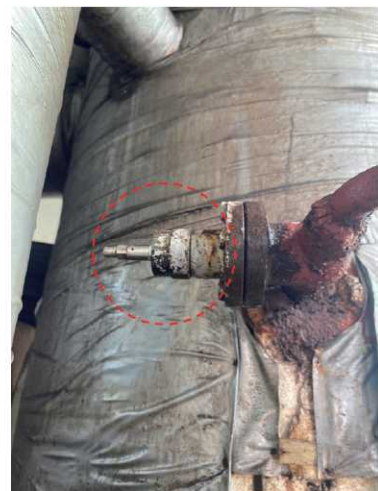
〈내부 패킹이 파손된 밸브 몸체〉
