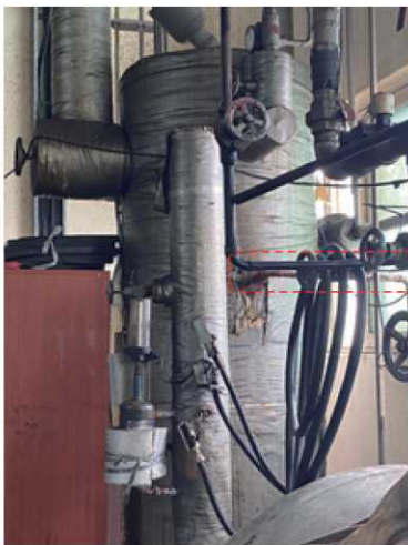
〈중간냉각기에 설치된 배관과 밸브(적색)〉
