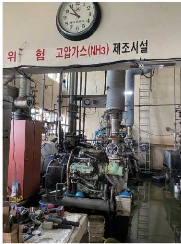
〈사고가 발생한 3층 압축기실〉
