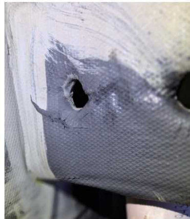
〈내부 라이닝 크랙 - 입고 배관 지지대〉
