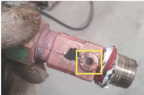
〈사고가 발생한 염소 실린더 안전밸브〉
