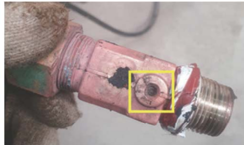
〈염소 누출이 발생한 염소용기 안전밸브〉
